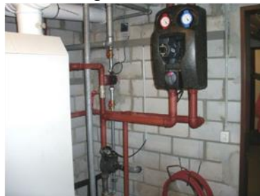
Neubau: Erdgastherme mit Boiler. Einsparung durch Weglassen Dämmung CHF 300.00 Mehrverbrauch in 25 Jahren CHF 600.00
